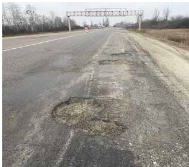
Рис. 1. Загальний вигляд ділянки дороги після закінчення зимового періоду
